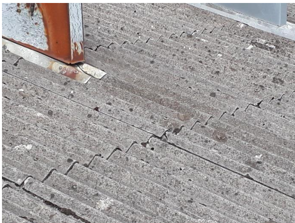
Enkelte ventilationshætter på bygningen er i dårlig stand
