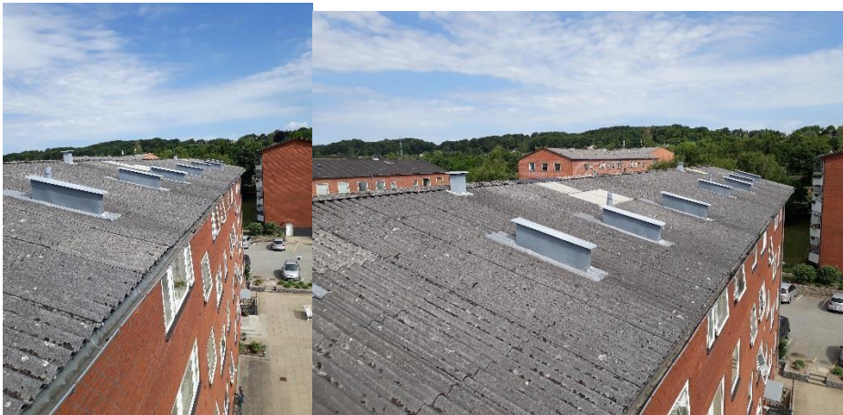
Inddækninger ved ventilation er i rimelig stand. Tagrender er med begyndende rust.
