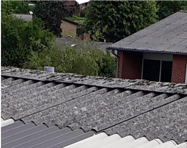
Rygninger er revnet og er porøse
