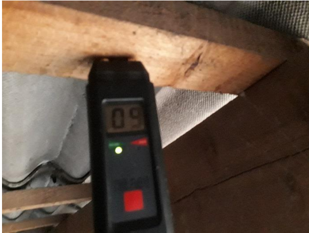
Fugtighed i spær og lægter er tørt
