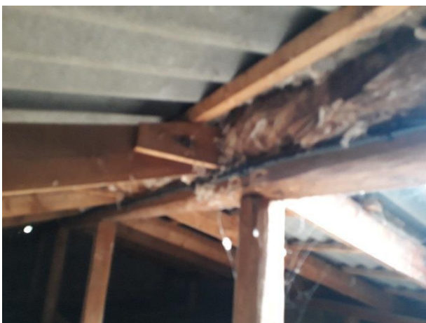
Kip er tætnet med mineraluld, bør være fugleklodser. Isoleringen kan suge vand og optugte spær og lægter.
