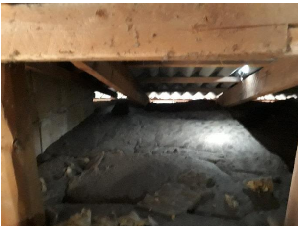
Hul i tagplade samt manglende fugleklodser ved tagfod
