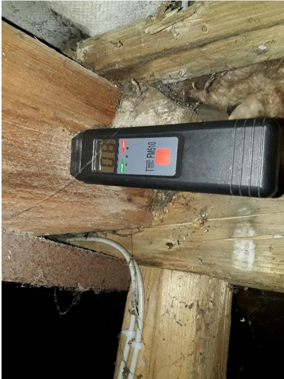
Tegn på opfugtet træ i loftrum, men spær og lægter meget tørt ved besigtigelsen, vurderes at skyldes meget tørt vejr den seneste måned.
