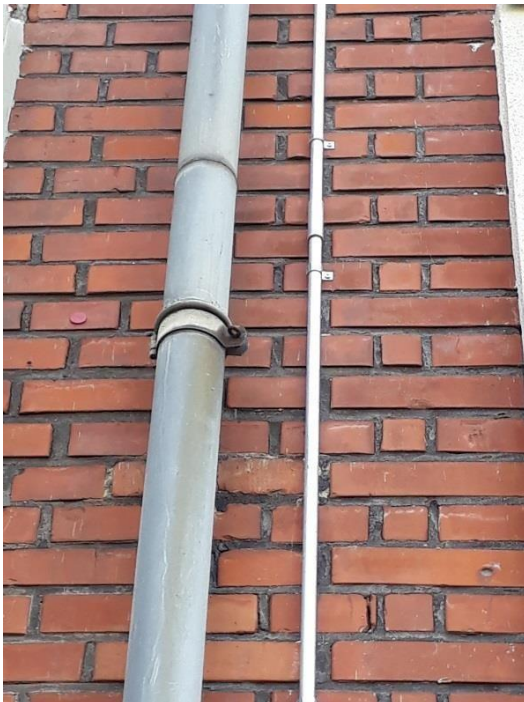
Samlinger på faldstammer er mange steder med begyndende rust/korrosion.
