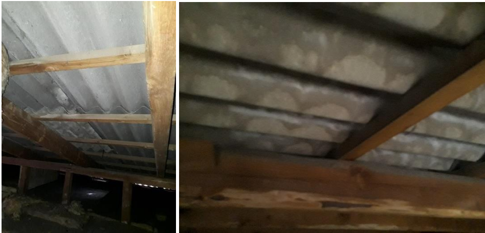
Fugtskjolder bag på tagplader, manglende tætning mellem plader
